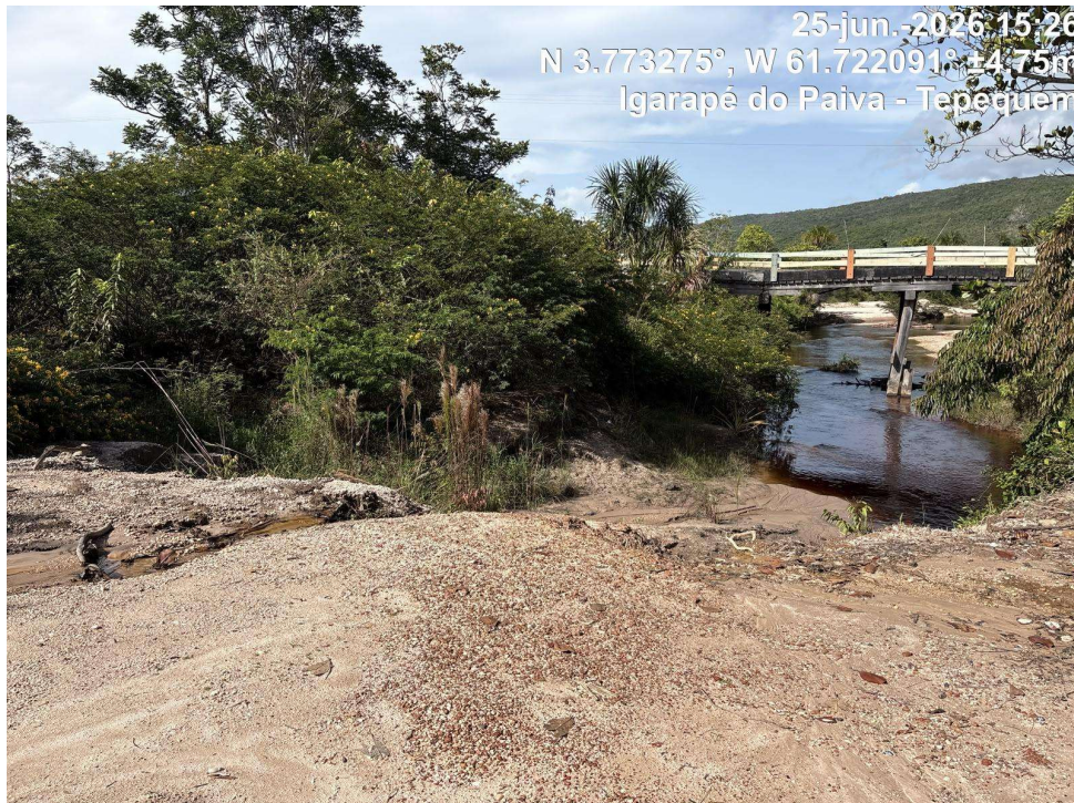
Figura 4. Processo erosivo na margem do Igarapé do Paiva decorrente da supressão da mata ciliar.
